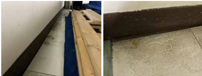
図3：外部倉庫の貸区画 壁際の水溜り
